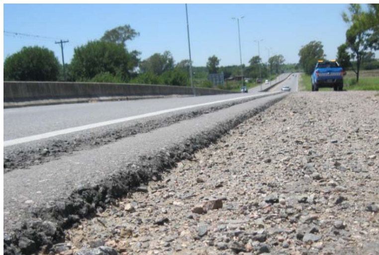
Foto 3. Caída del borde de pavimento
