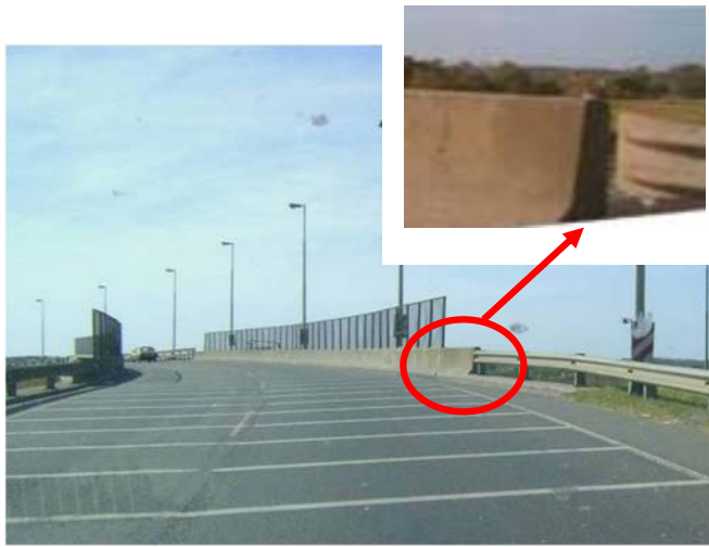
Foto 5. Falta de continuidad geométrica y estructural entre barreras de diferente rigidez.
